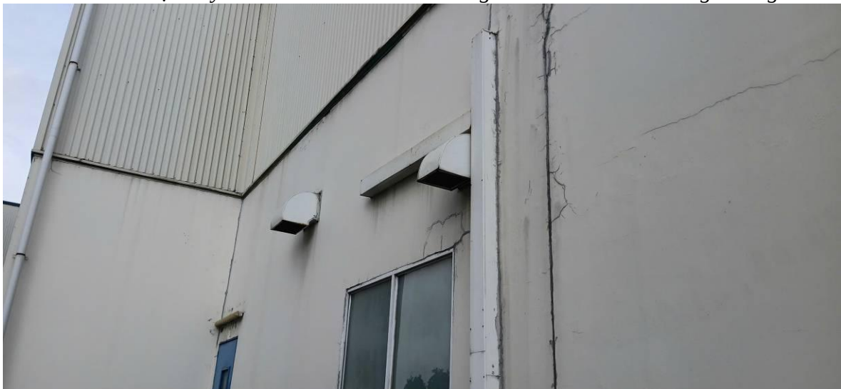
Ống thông gió nhà xưởng
