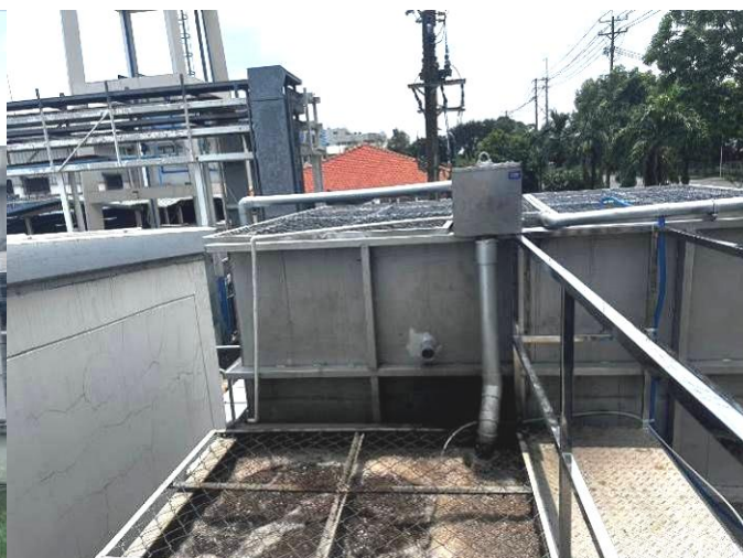
Bể điều hòa và hộp điều chỉnh lưu lượng
