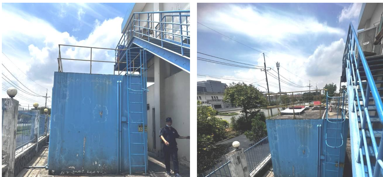
Hình 3.7. Hệ thống xử lý nước thải tại nhà máy 2.
